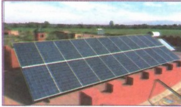
ألواح شمسية لإنتاج الكهرباء.
